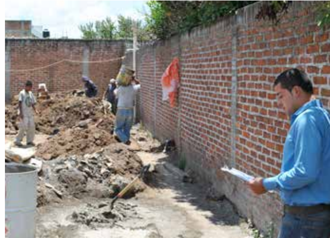
Inspección y revisión de licencias de construcción
